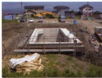
汚水処理施設
